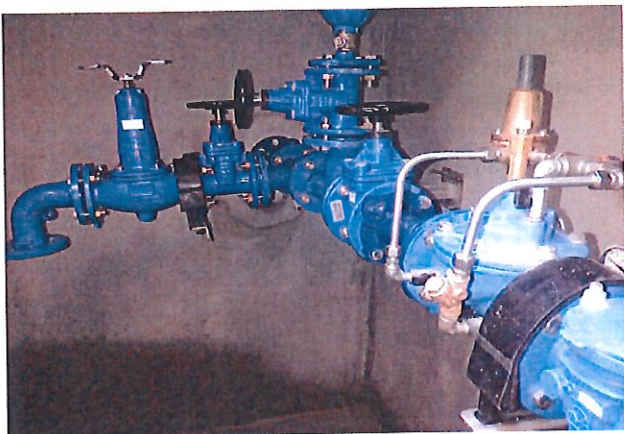
Equipement intérieur d'un regard de régulation
